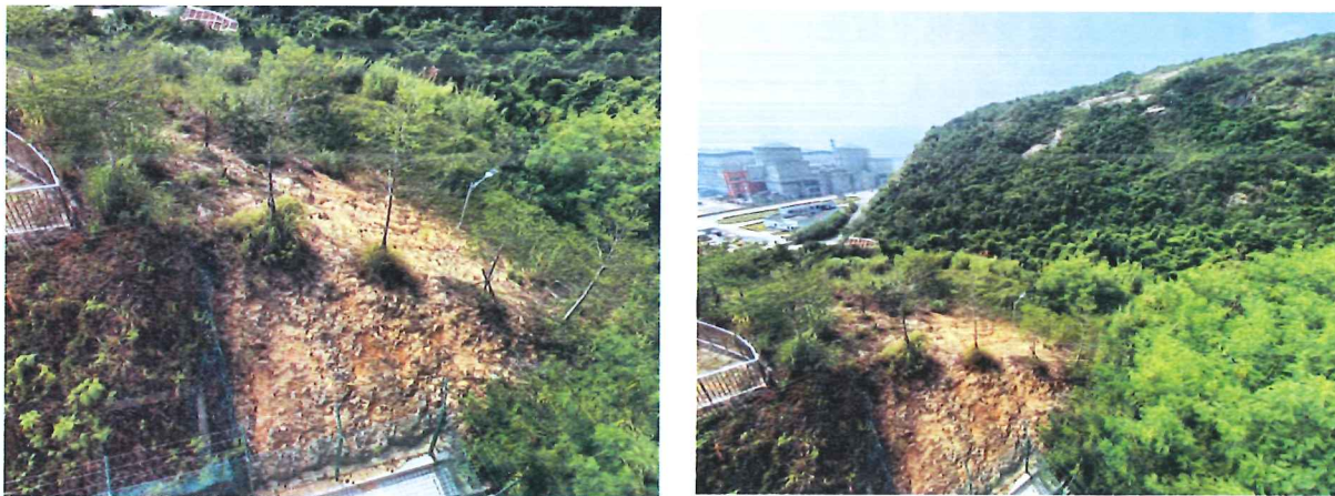
图 12-1 水箱周边部分边坡裸露现状
