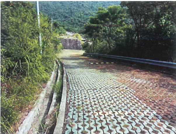
09 登山道排水沟现状
